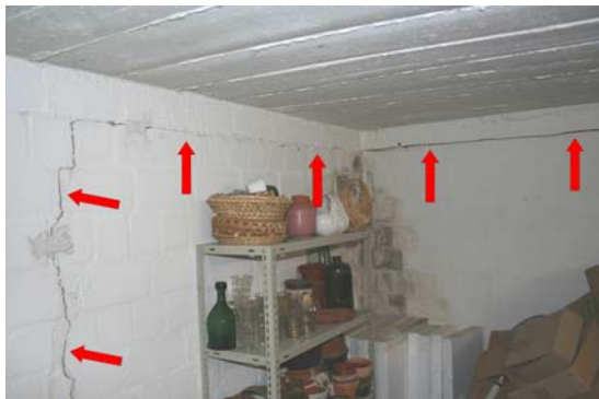
Bild 1: Kellergeschoss, Wandrisse und Mauerwerksverschiebung
