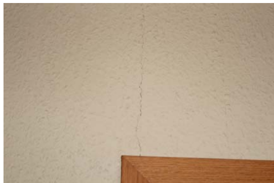
Bild 4: Erdgeschoss, Wohnzimmer, Wandriss
