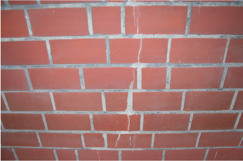
Abb.: 12.3 Beispiel für eine mangelhafte Rissanierung
