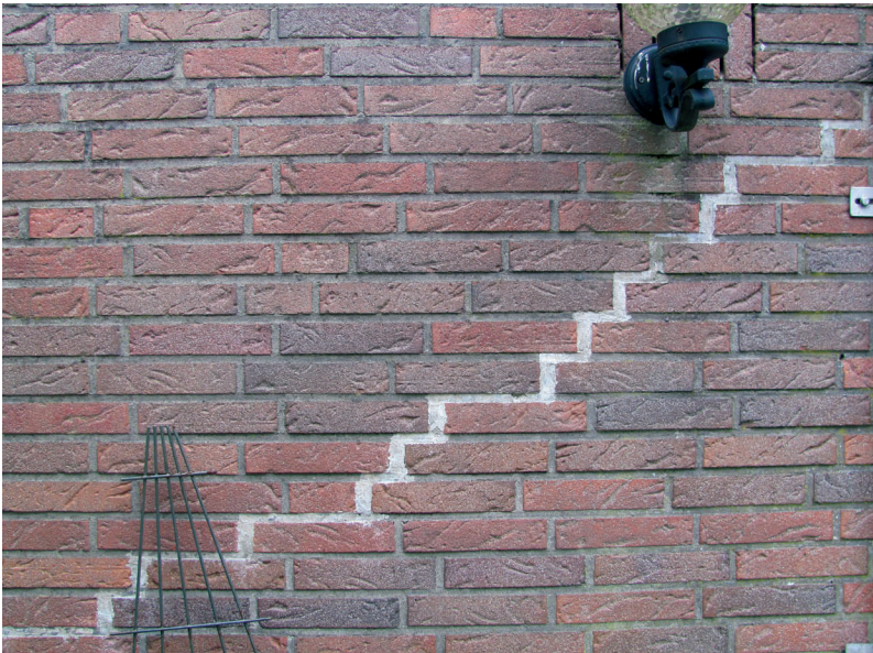
Abb.: 12.4 Beispiel für eine mangelhafte Rissanierung
